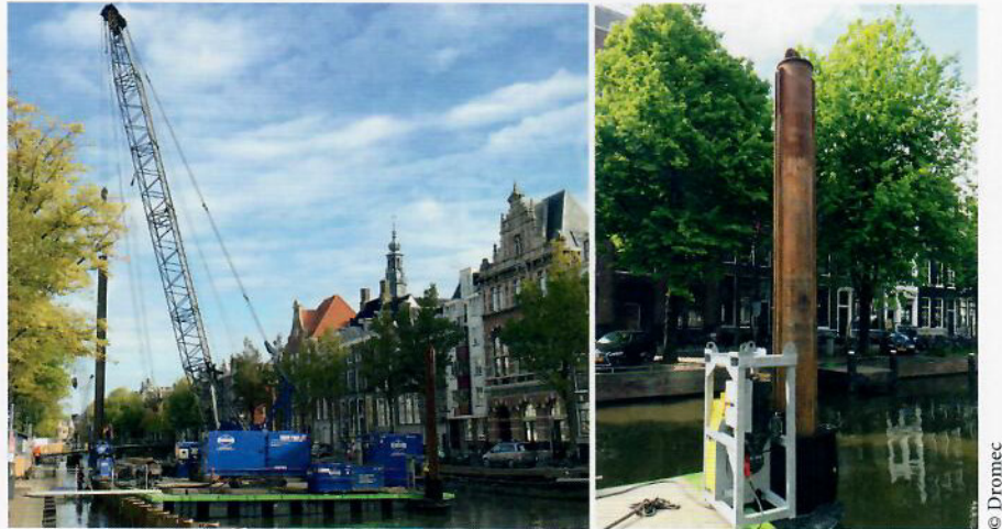
Ein Ponton, der mit den neuen Pfahlankerwinden (r.) ausgestattet ist, beim Einsatz in Amsterdam
